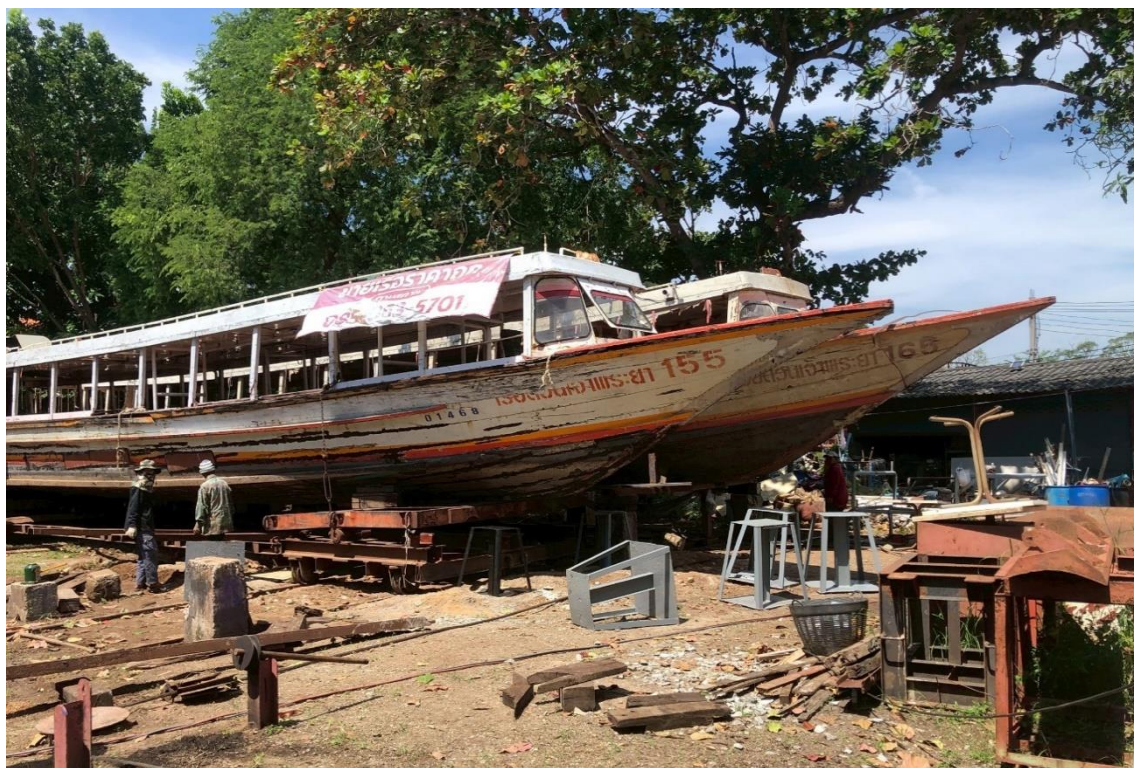
ภาพ บรรยากาศการปรับปรุงพื้นที่เพื่อเปลี่ยนตำแหน่งของเรือลำกลางให้มาตั้งชิดกับเรือด่วนเจ้าพระยาด่านขวามือ ต้องมีการสร้างโครงสร้างฐานรากและคานเรือชุดใหม่เพื่อรองรับ
