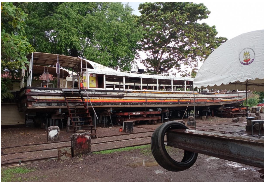
ภาพ การติดตั้งบันไดเหล็กเพื่อขึ้นเรือด่วนเจ้าพระยา
